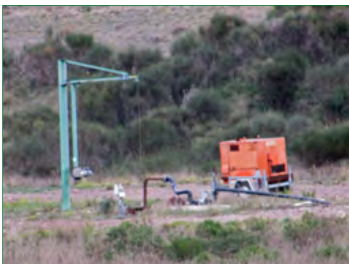
Système de pompage
