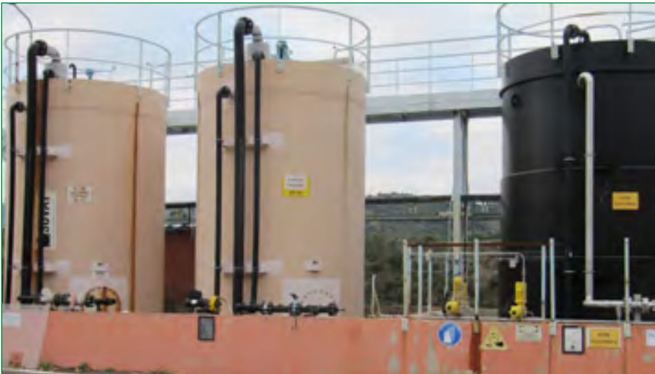
Les cuves de décantation et rétention
